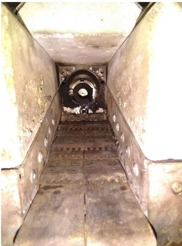
Obr. 10: Čelní pohled do zvoleného roštového hořáku.
